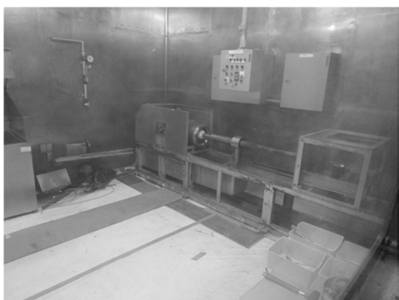
カプセル除染装置外観（除染フード内）
